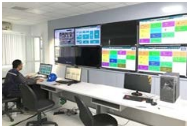
▲ Màn hình SCADA và camera giám sát, điều khiển hoạt động hệ thống hồ FHS
