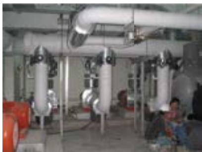
Hệ thống Cấp nhiệt - Điều hòa không khí trung tâm
