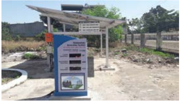
▲ Thiết bị đo hệ thống phát điện mặt trời được lắp đặt tại huyện Ea Súp
