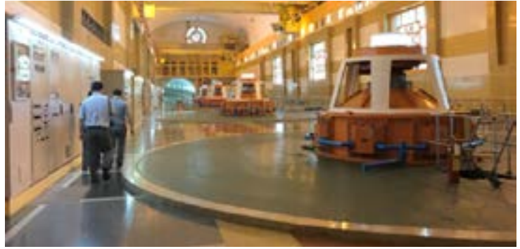
▲ Tổ máy phát điện Nhà máy Thủy điện Ialy
